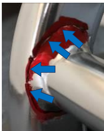
写真2 (使用中止) 溶接止端に大きなヒビがある(青矢印)。ヒビの部分の色が線状に濃くなっている。
